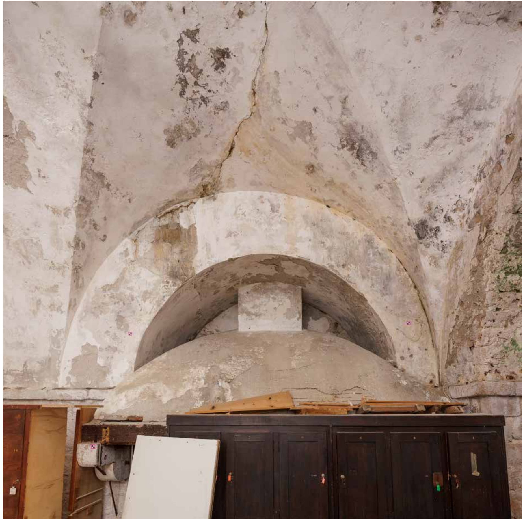
Detalj nape kamina
