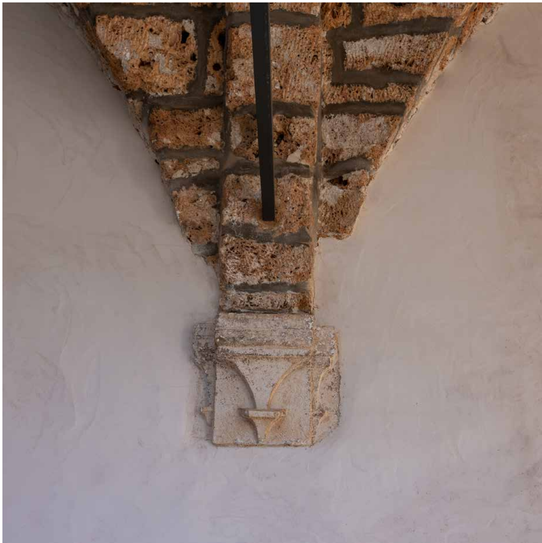
Debeo nanos cementne žbuke uz konzolu svoda u trijemu zapadnog krila i tamne cementne fuge
