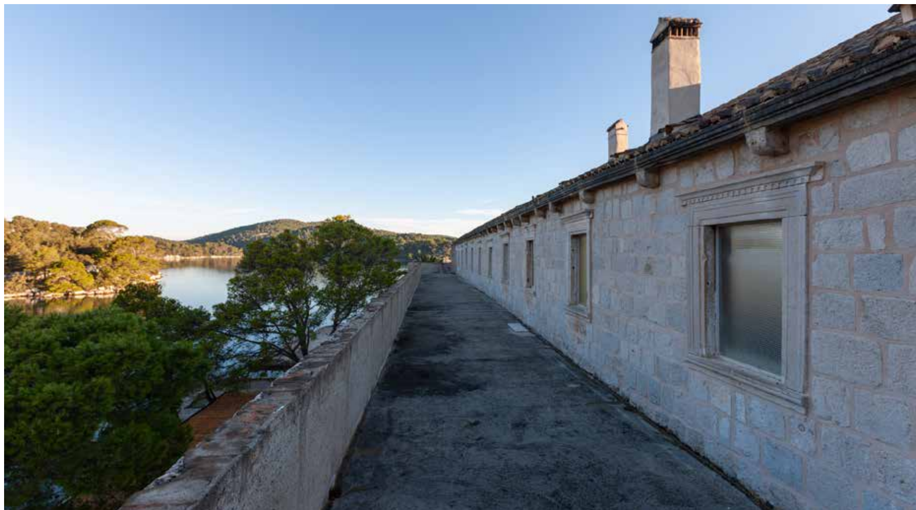
Zapadno krilo, terasa na gornjoj razini uz zapadno pročelje s prozorima ćelija
