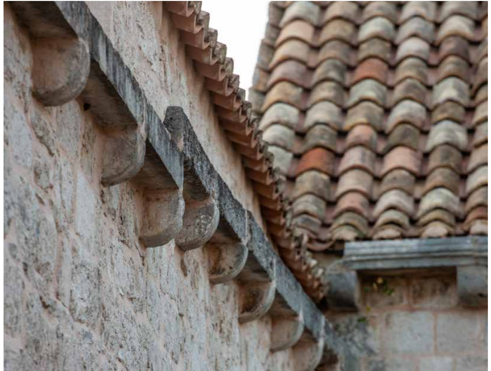
Sjeverno pročelje, žlijeb
