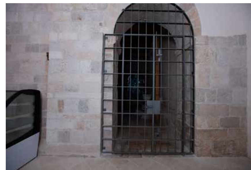
Smanjeni prozor na mjestu nekadašnje bifore zapadnog pročelja crkve
