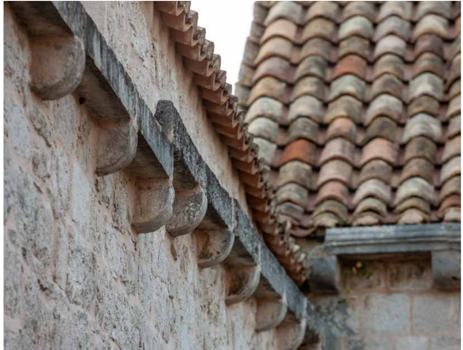
Sjeverno pročelje, žlijeb
