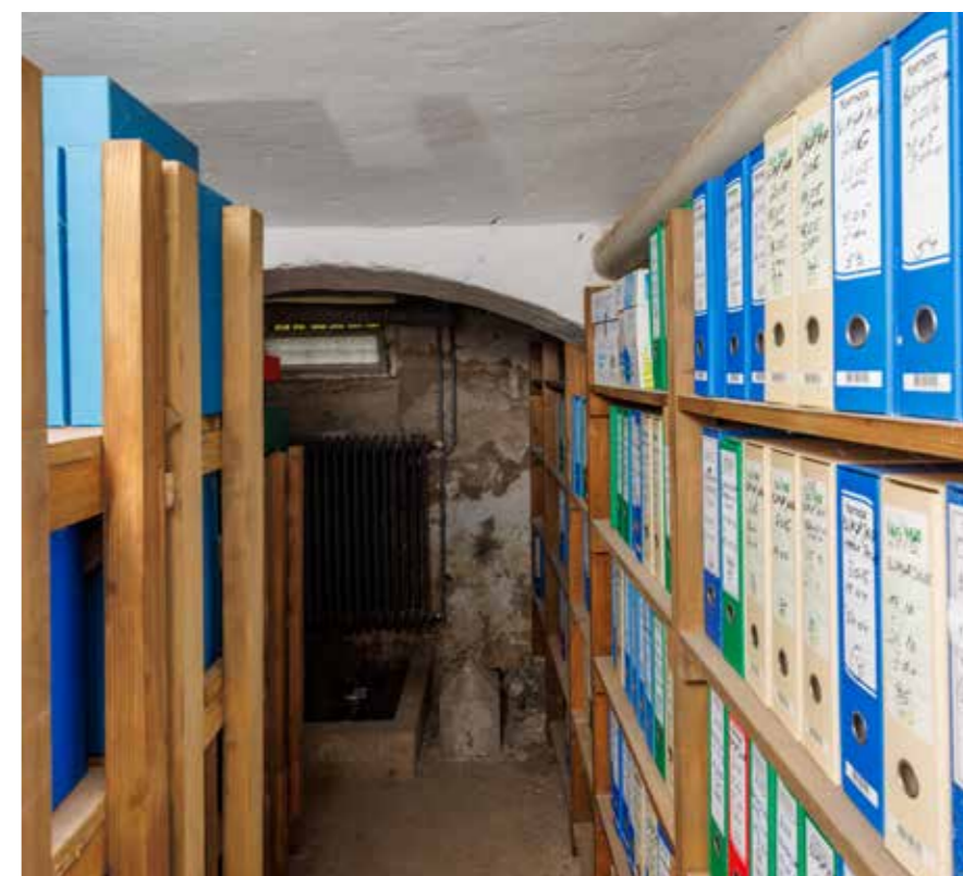
Bunjato u prizemlju, oštećenja
