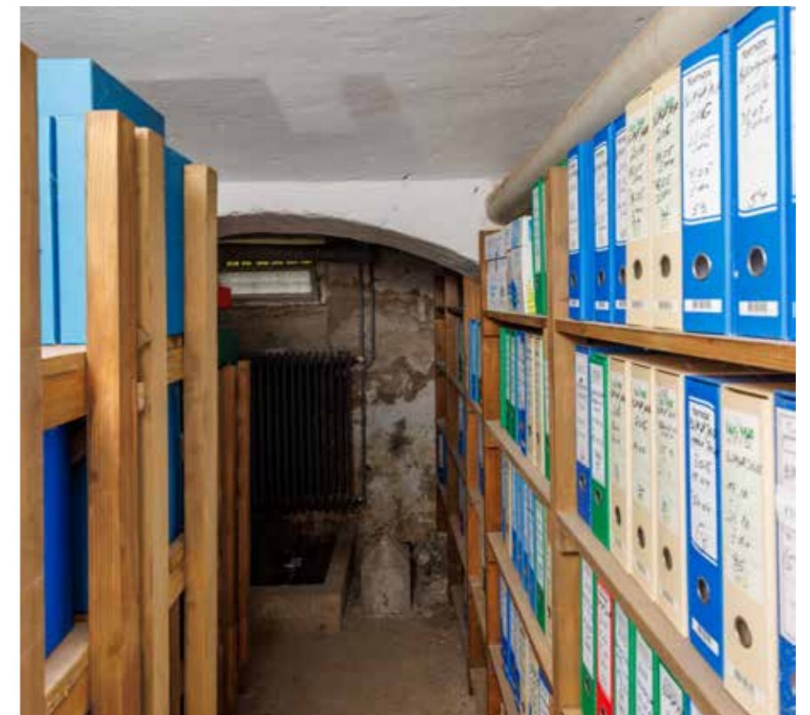
Bunjato u prizemlju, oštećenja
