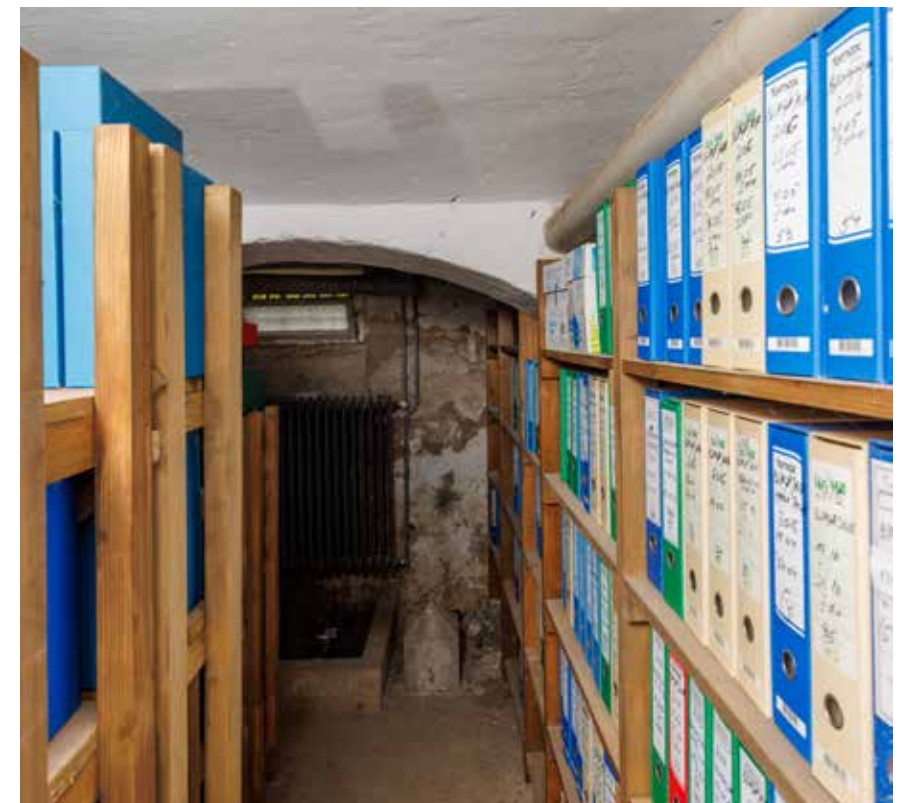
Bunjato u prizemlju, oštećenja
