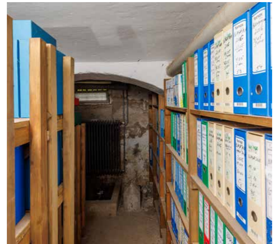
Bunjato u prizemlju, oštećenja
