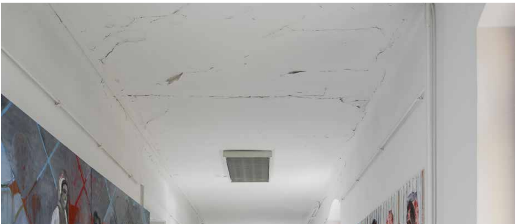
Interijer oštećen u potresima 2020.
