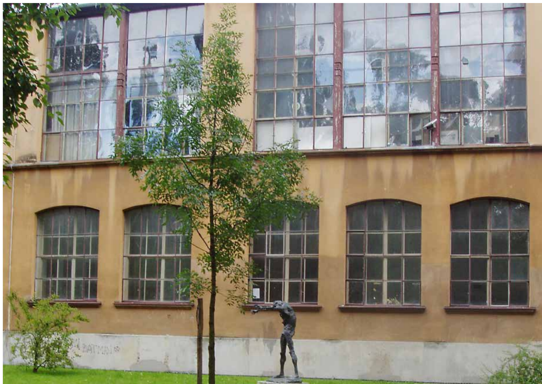
Umjetnički ateliji prema projektu Hermana Bolléa, sjeverno pročelje prije posljednje obnove 2010. godine, Grad Zagreb, Gradski zavod za zaštitu spomenika kulture i prirode (foto: S. Novak)
