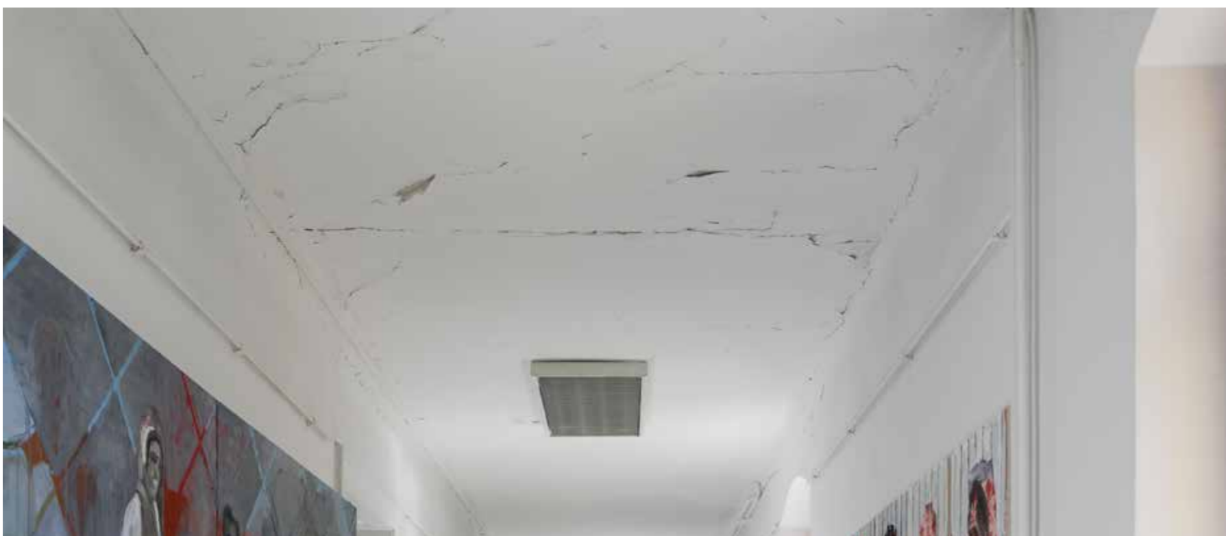
Interijer oštećen u potresima 2020.
