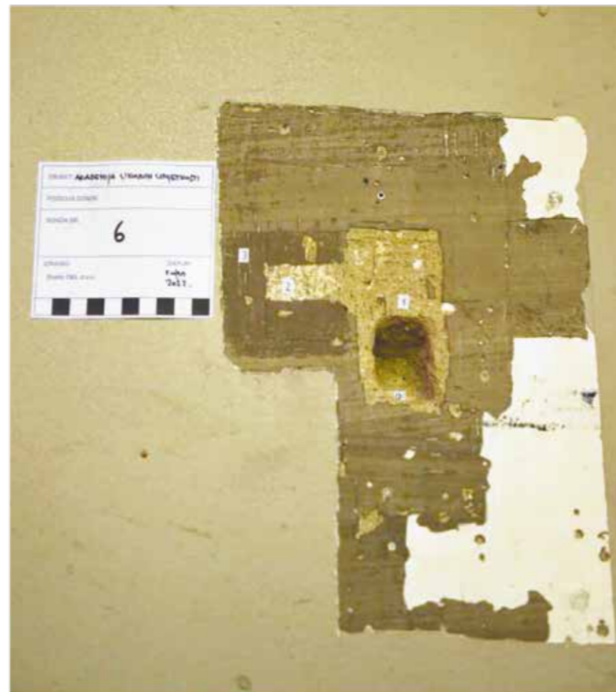
Sonda br.6 I kat, zapadno krilo, atelje, zid između ateljea i hodnika
