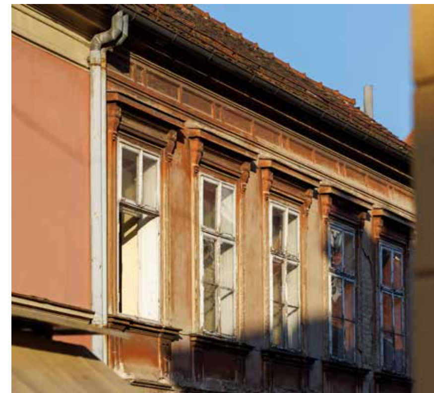
Sjeverno pročelje, dograđeno krilo
