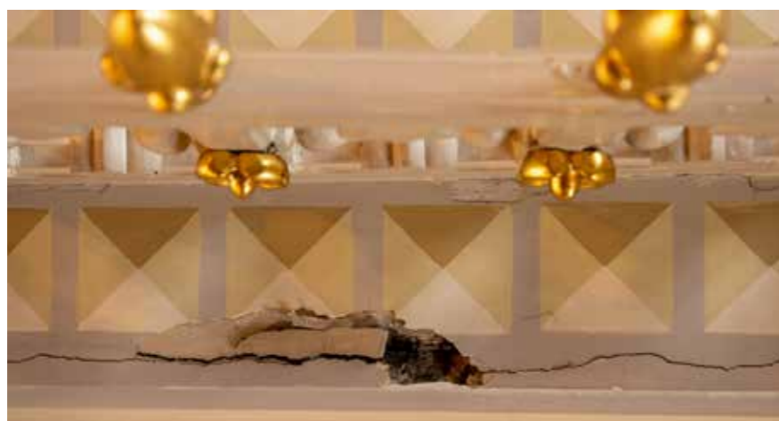
Pogled na stropnu plohu Ilirske dvorane, oštećenje zatečenog žbukanog i slikanog sloja, detalj pukotine
