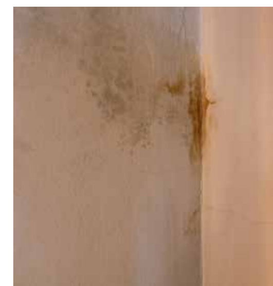
Pogled na južni zid galerije Ilirske dvorane, oštećenje zatečenog žbukanog i slikanog sloja, detalj
